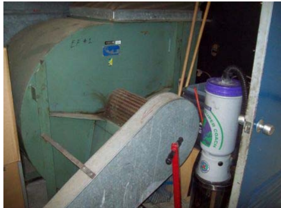
Photo #88: Auditorium exhaust fan
